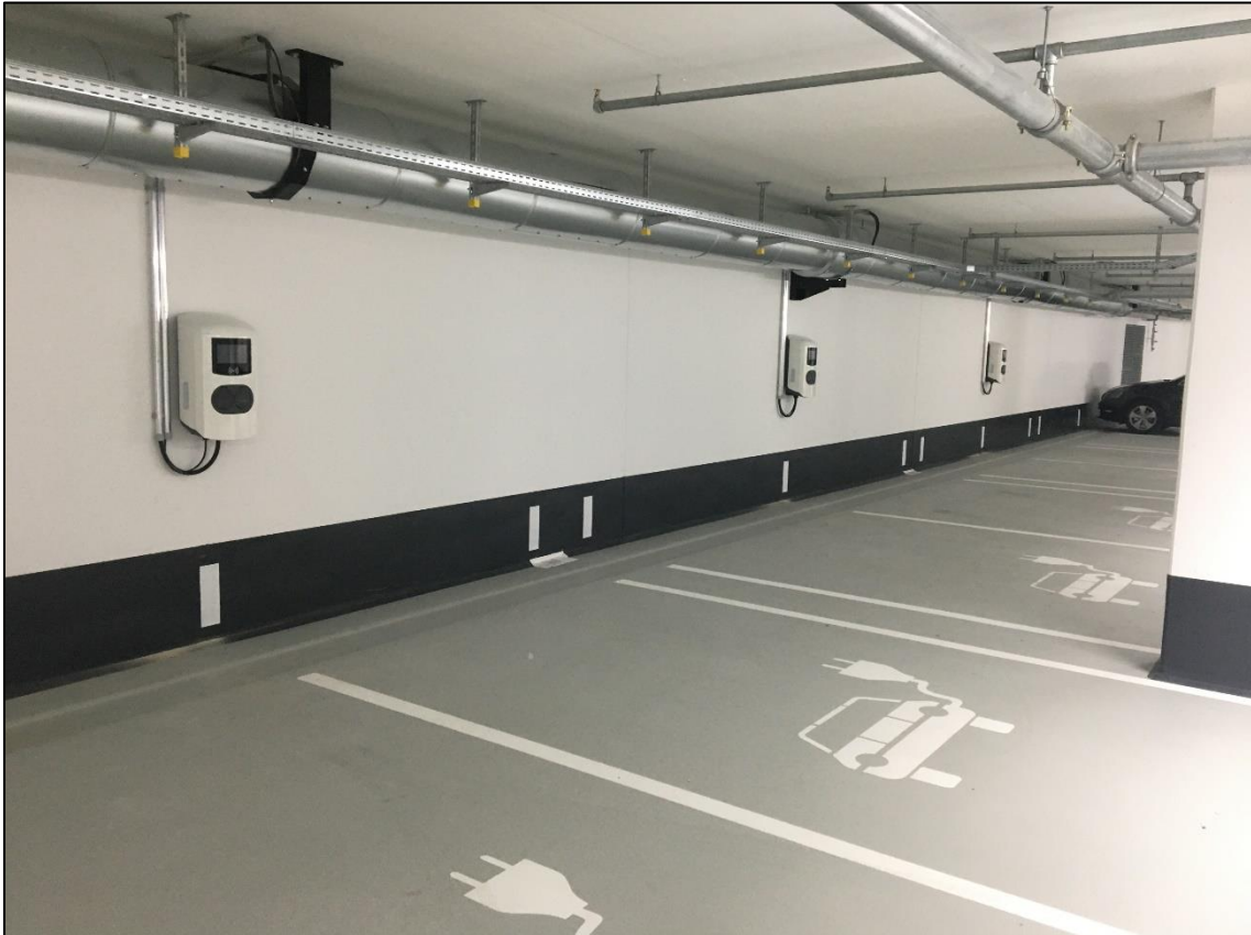
Beispiel einer Neubau-Tiefgarage mit einheitlicher Hardware-Ausstattung. Bildquelle: badenova
